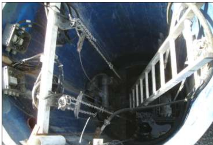
Figure 6 : Station de relevage des eaux usées du Jorrax
