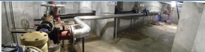
Station de pompage des Iles
